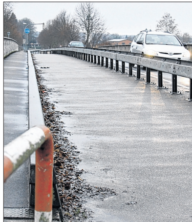
Die Brücke im Verlauf der L 205 ist marode. Sie sollte bereits 1992 saniert werden.
